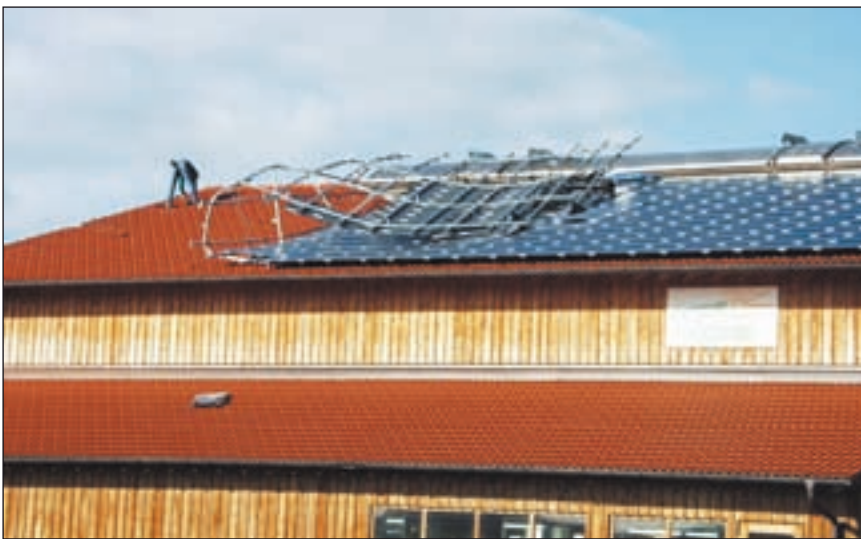
Sturmschaden an einer Photovoltaikanlage durch Windsog im Randbereich
