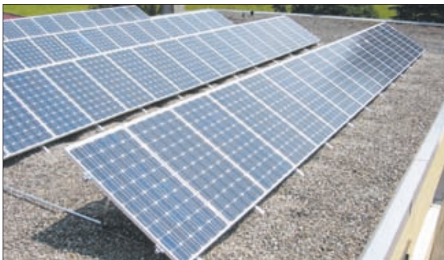
Photovoltaikanlage mit Randabstand zur Vermeidung zusätzlicher Windlasten
