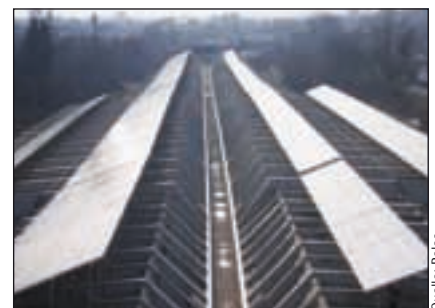
Mit 2.700 m Länge wird die PV-Anlage ca. 2.650 kW leisten
