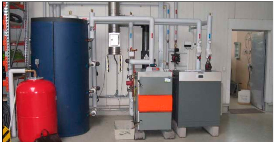
Bild 2: (v.Li.) Ausgleichsgefäß, Pufferspeicher, Heizkessel, Wärmepumpe
