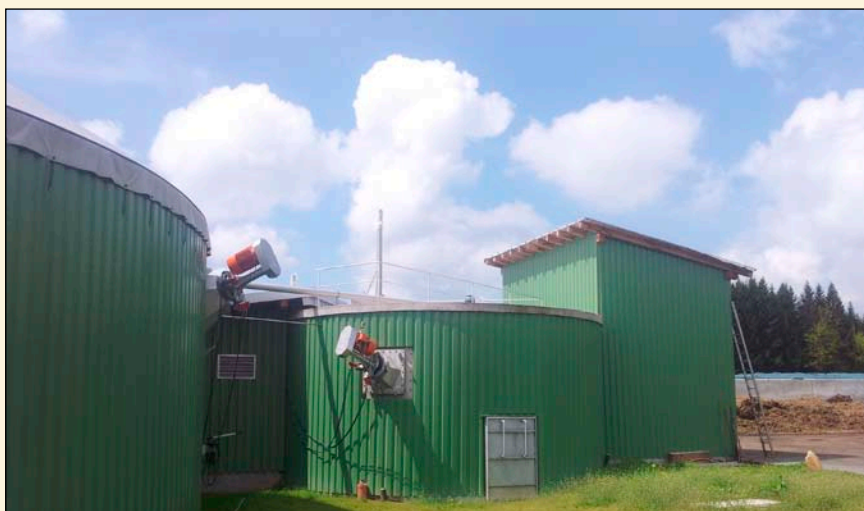
Bild 1: Hydrolysetanks ermöglichen die Vergärung faseriger Einsatzstoffe.
