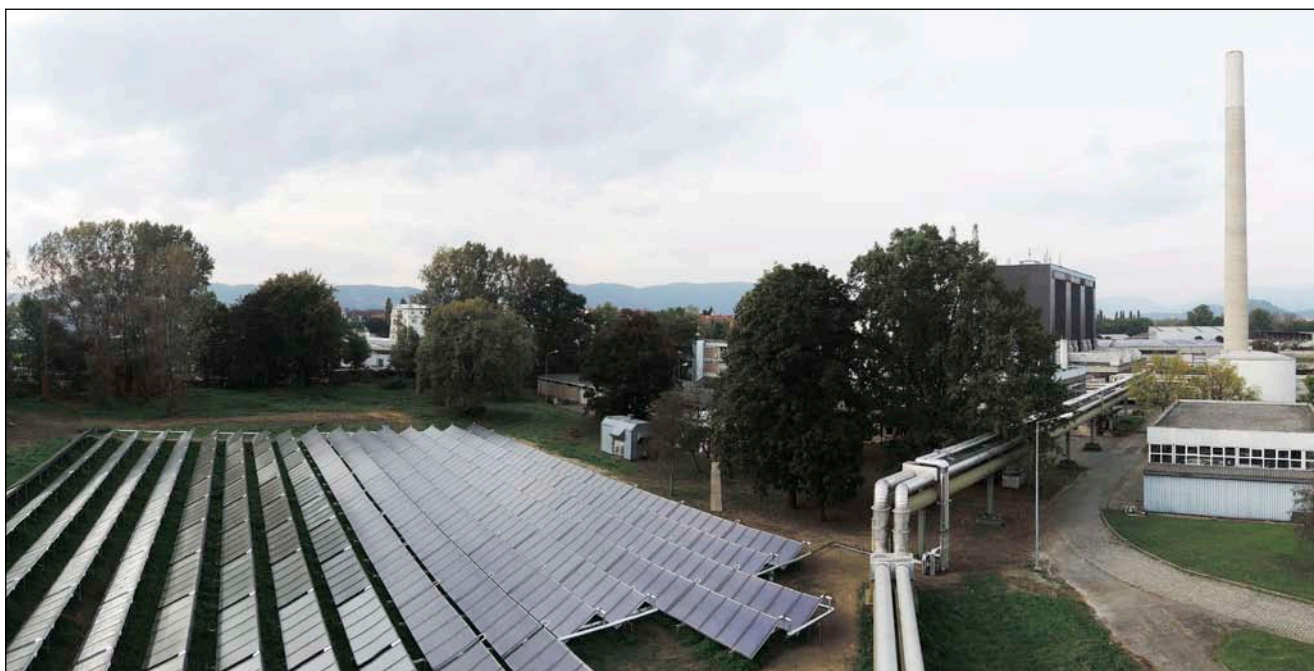
Bild 2: Kollektorfeld am Fernheizwerk der Energie Steiermark in Graz, das mit Kollektoren von vier verschiedenen Herstellern bestückt wurde.
