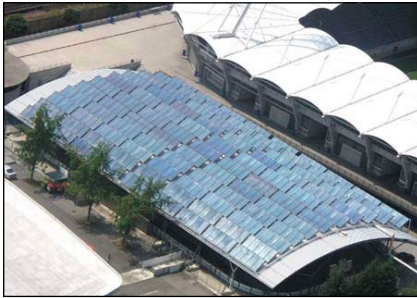
Bild 1: Bereits 2002 wurde die erste solarthermische Großanlage mit 1.407 m 2 Kollektoren zur Unterstützung der Fernwärme auf der UPC Arena in Graz errichtet. Heute sind es bereits über 16.000 m 2 .
