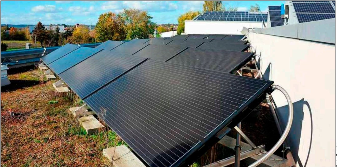
Bild 1: Hybridanlage mit PVT-Kollektoren liefert Strom und Wärme
