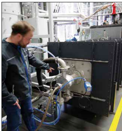
Bild 1: Energietechnik-Abteilungsleiter Martin Meiller an einem FLOX-Brenner, wie er auch im BO 2 CCU-Projekt eingebaut werden soll.
