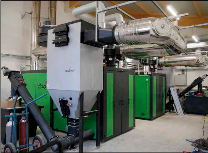
Bild 1: Blick auf die zwei Hackschnitzelkessel-Zwillinge im Sammenheimer Heizwerk. Im Vordergrund (grau) der Zyklonabscheider eines Kessels.
