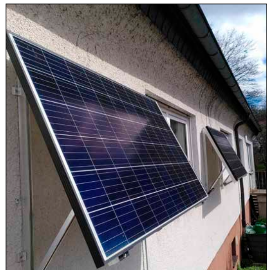
Bild 3: Das Balkonkraftwerk des Kinderhorts Bossebande an der Südfassade.
