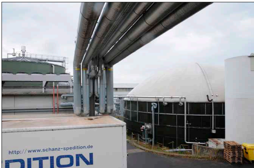
Bild 2: Die Biogasanlage auf dem Firmengelände in Brensbach umfasst unter anderem einen hohen Fermenter (links hinten), das Blockheizkraftwerk (zwischen dem Fermenter und den Containern) sowie einen Kombispeicher mit Gasspeicher (rechts).
