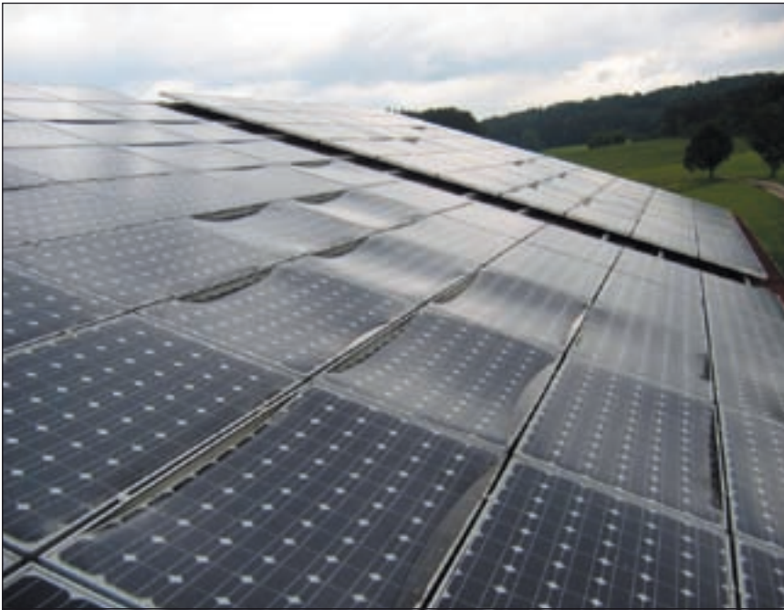
Schneedruckschäden an einem Photovoltaik-Modulfeld
