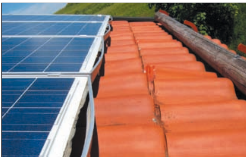
Schäden an Modulrahmen durch die Hangabtriebskraft von Schnee
