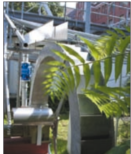
Bild 2: Das ABC der Kleinwasserkraftnutzung – ein oberflächliches Wasserrad
