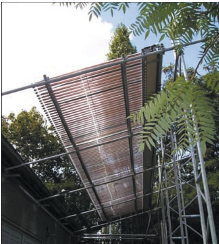
Bild 3: Spezielle Vakuumröhrenkollektoranlage zur Einspeisung eines Langzeitspeichers
