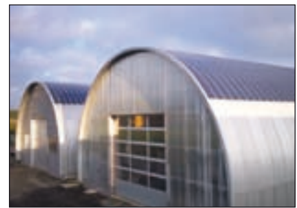
Bild 5: Amorphe Tripelsolarmodule „Dachplates“ auf Tonnendach [Biohaus]
