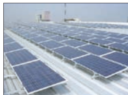
Bild 6: Solarmodule auf einem TESCO Supermarkt
