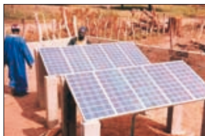
Dezentrale Anlagen auf Basis erneuerbarer Energien erzeugen den Strom dort, wo er gebraucht wird: in entlegenen Dörfern.
