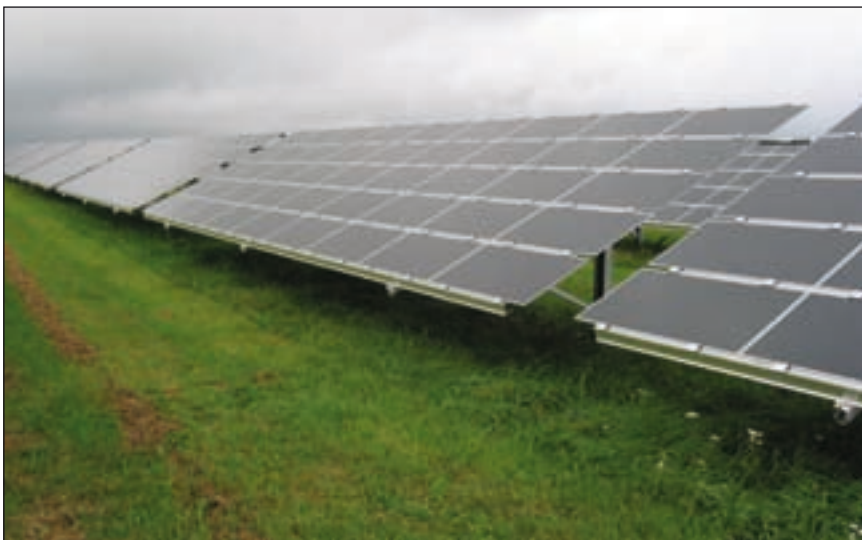
Dünnschicht-Module im Einsatz bei einer Großanlage nahe Leipzig
