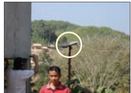
Bild 8: Verschattetes Module für Stromversorgung der Nachführung
