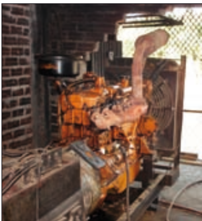
Bild 3: Generator für ein kleines Netz in Kambodscha
