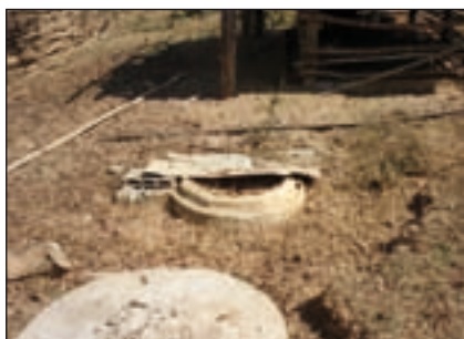
Bild 13: Biogasanlage außer Betrieb
