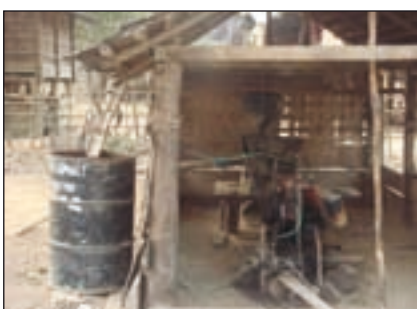
Bild 4: Dieselgenerator für den Betrieb einer Reismühle
