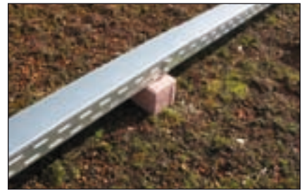
Bild 3: Die Stromkabel dieser Großanlage auf einem begrünten Flachdach wurden in einem geschlossenen Kabelkanal verlegt.
