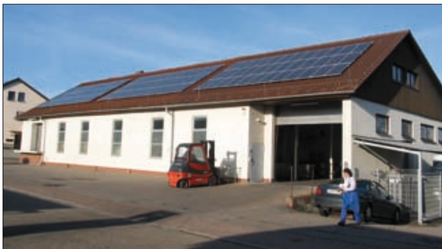
Bild 5: Eine Solarstrom-Gemeinschaftsanlage kurz nach Fertigstellung. Sichtbar auch die Einbeziehung der Anlage in den Blitzschutz des Gebäudes durch Fangstangen im First- und Traufbereich.
