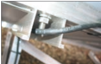
Bild 4: Diese Kabelverlegung gehört als Mangel in das Abnahmeprotokoll: An den scharfen Kanten der Unterkonstruktion können die Leitungen scheuern und im schlimmsten Fall einen Kurzschluss verursachen.
