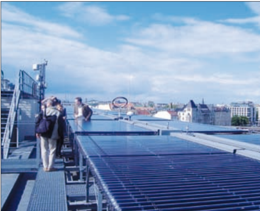
Bild 3: Thermische Solaranlage auf dem Dach des Presse- und Informationsamtes der Bundesregierung
