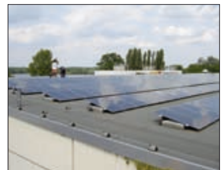
Bild 2: PV-Anlage auf dem Dach des Wasserwerkes Tegel der Berliner Wasserbetriebe
