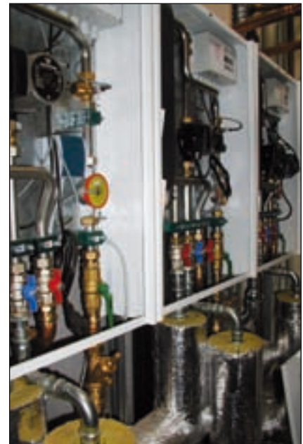
Bild 4: Das Herzstück der Anlage: die drei SOLEADO Frischwasserstationen
