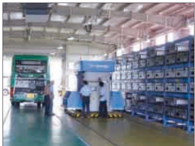
Bild 6: Ein vollautomatisches Wechselbatteriesystem für Omnibusse während der Olympiade 2008 in China.
