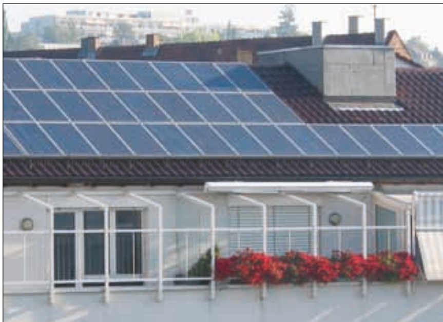
Der Abstand zum Dachrand verhindert, dass Regenwasser über die Rinne hinauschießt.
