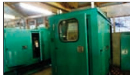
Blick auf die Generatoren
