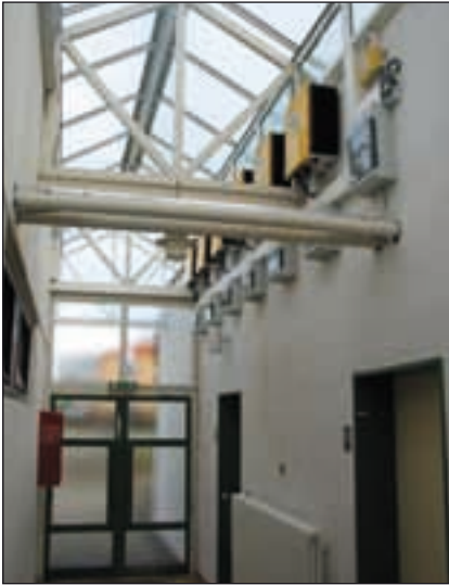
Wechselrichter in sicherer Höhe. Hier können von Besuchern des Gebäudes keine Kabel gezogen werden.
