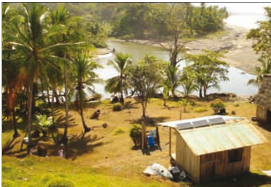
Bild 1: Punta Burica, Costa Rica – Photovoltaikanlage die für Beleuchtung, Internet und Telefon in einer Unterkunft für Ökotourismus verwendet wird.
