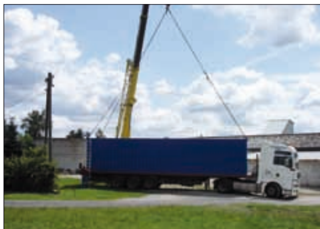
Bild 3: Aufstellung des Gascontainers der Pilotanlage
