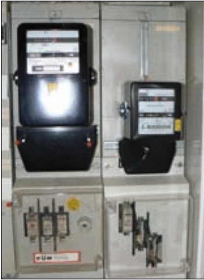
Zwei Zähler im Haus, der rechte zählt die erzeugten kWh der PV-Anlage
