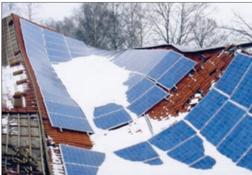
Durch Schneedruck beschädigte Photovoltaikanlage
