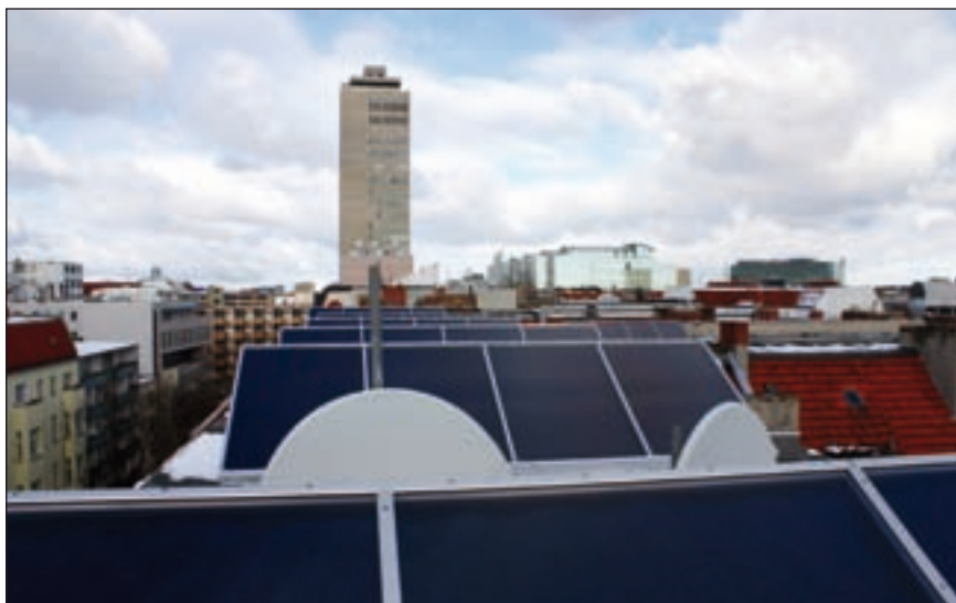
Bild 2: Solarkollektoren auf dem Dach der Pfalzburger Strasse 82 in Berlin-Wilmersdorf, in Betrieb seit 2009
