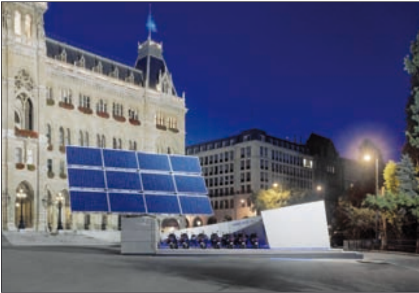
Bild 1: Netzautarke Ladestation von Solon mit RedOx-Flow-Pufferakku
