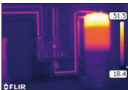
Der Schichtspeicher während der Beladung
