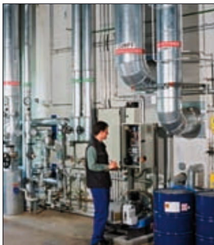
Bild 1: Biomasseheizkraftwerk Pfaffenhofen: Kontrolle des Steuerschranks der Vakuumpumpe
