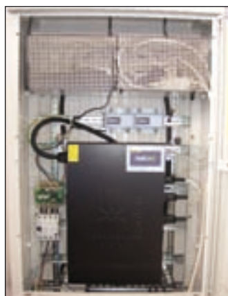
Bild 3: Der Anschlusskasten mit der Energieverteilterchnik (schwarze Box) und dem Prototypen einer Powerbee (grüne Platine links).
