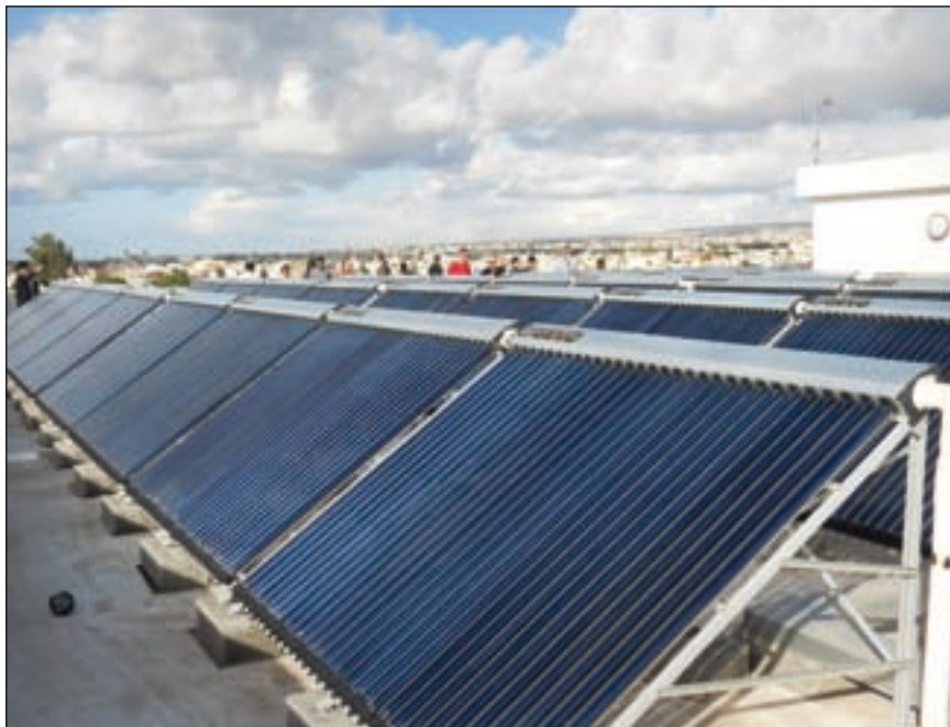
Kollektoranlage der Fa. GEVO in Limassol zum Antrieb der Absorptionskältemaschine
