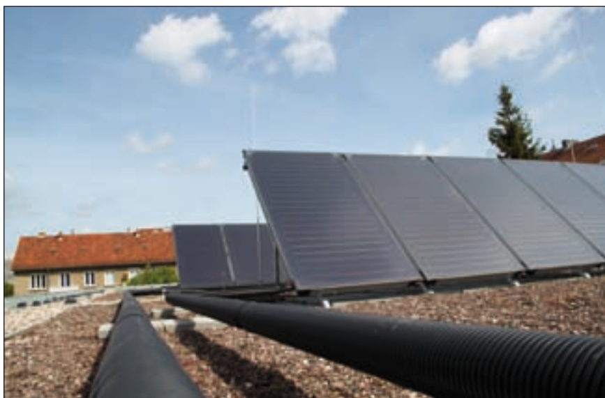
Bild 1: Aufgeständerte Kollektoren auf dem Flachdach der Hermann-Hesse-Strasse 3 a-c im Berliner Stadtteil Pankow
