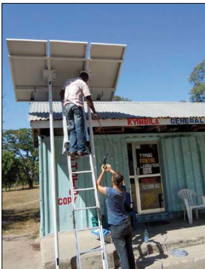
Bild 4: Dritter Platz: Projekt „Generator Zero“ von Renewable Energy Association in Tansania
