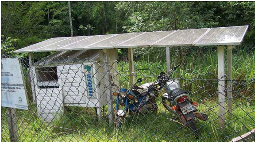
Bild 1: Heute dienen die Solarmodule als Garage für die Motorräder
