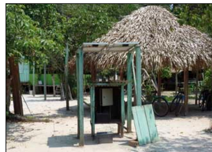
Bild 2: Noch vor 1 Jahr legten die Hühner hier ihre Eier ab, in diesem Jahr wurde eine neue Batterie gekauft und das SHS wieder in Betrieb genommen
