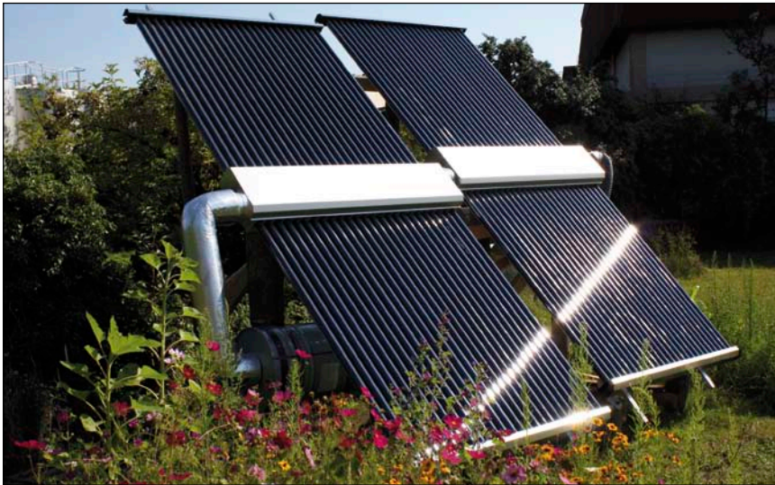
Bild 1: Kollektoranlage zum Bambustempen in Bötzingen (Typ „Sunstorm“, Kollektorfabrik)
