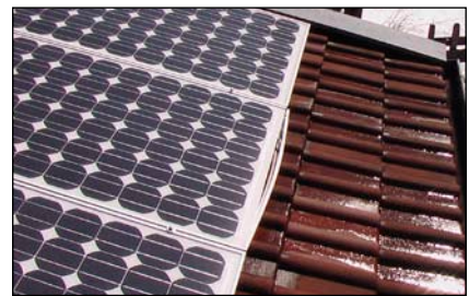
Bild 1: Das Modulglas wurde durch die Schneelasthäufung an der Rahmenkante aus Rahmen gedrückt.
