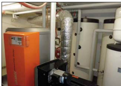
Bild 3: Heizkessel mit Hackschnitzelzuführung (unten rechts) vom Hackschnitzelspeicher kommend. Im Hintergrund zwei 500 l Pufferspeicher. Die Rauchgase werden durch das diagonal und isoliert verlegte Rohr dem Schornstein zugeführt.
