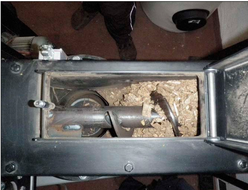
Bild 1: Rückbrandsichere Zuführung der Hackschnitzel zum Kessel
