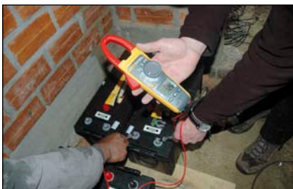
Bild 2: Installation der Batterien und Demonstration der Spannungsmessung
