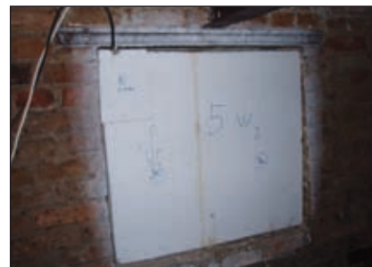
Bild 1: Unzureichende Dämmmaßnahmen im Keller
