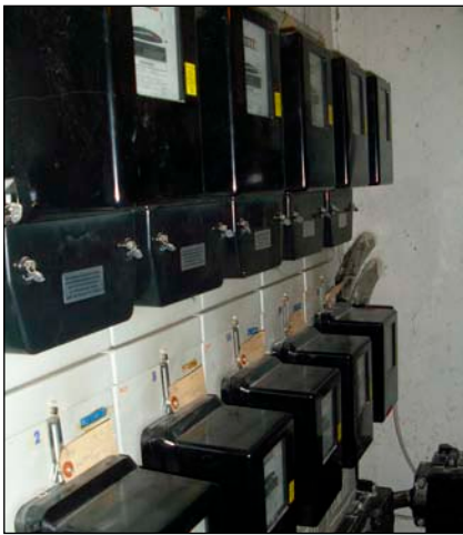
Bild 1: Klassische Zähleranlage eines Mehrfamilienhauses
