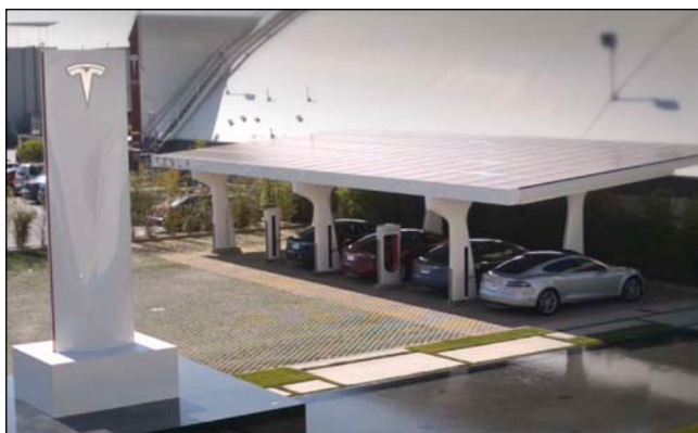
Bild 3: Tesla Supercharger dienen der Schnellladung mit bis zu 120 kW Leistung. Das Netzwerk für Langstreckenfahrten wird weltweit aufgebaut und soll Tesla Kunden lebenslang kostenlosen Strom bieten. In Norwegen steht die erste europäische Station.
