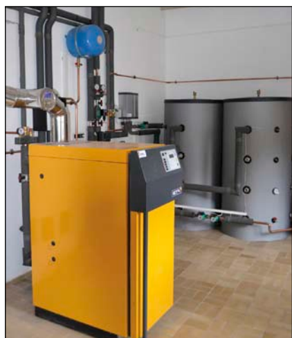
Bild 3: Scheitholzvergaser mit Pufferspeichern
