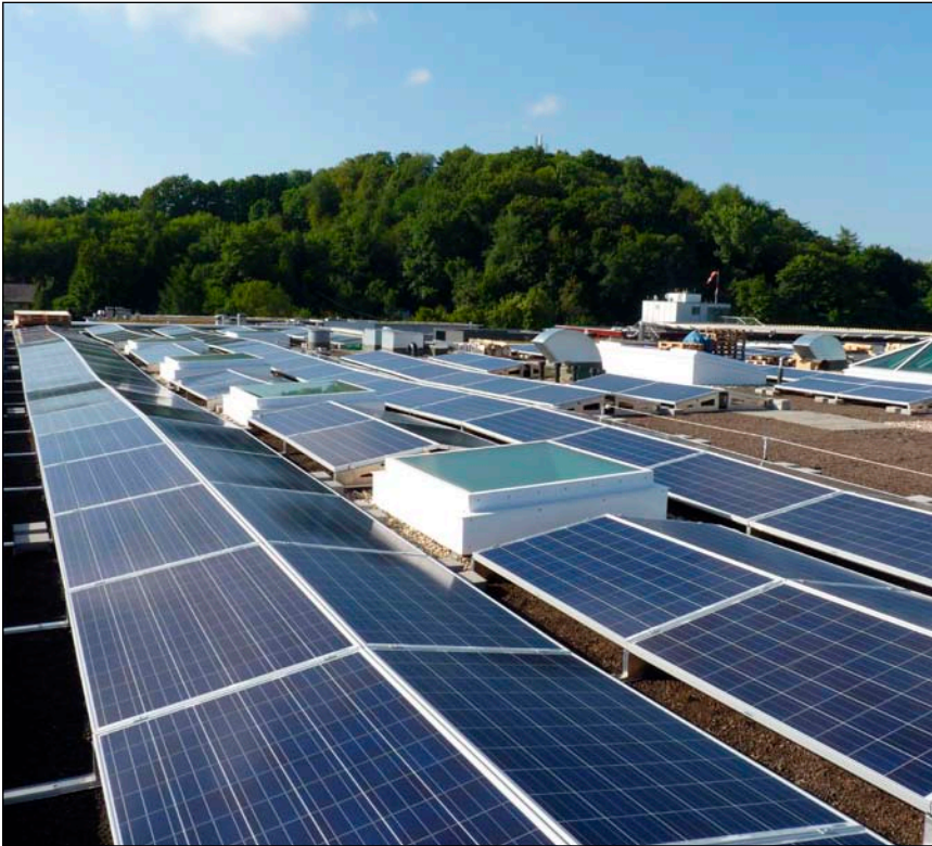
Bild 1: PV-Anlage mit Ost-West-Ausrichtung. Kommt die Südausrichtung zurück?
