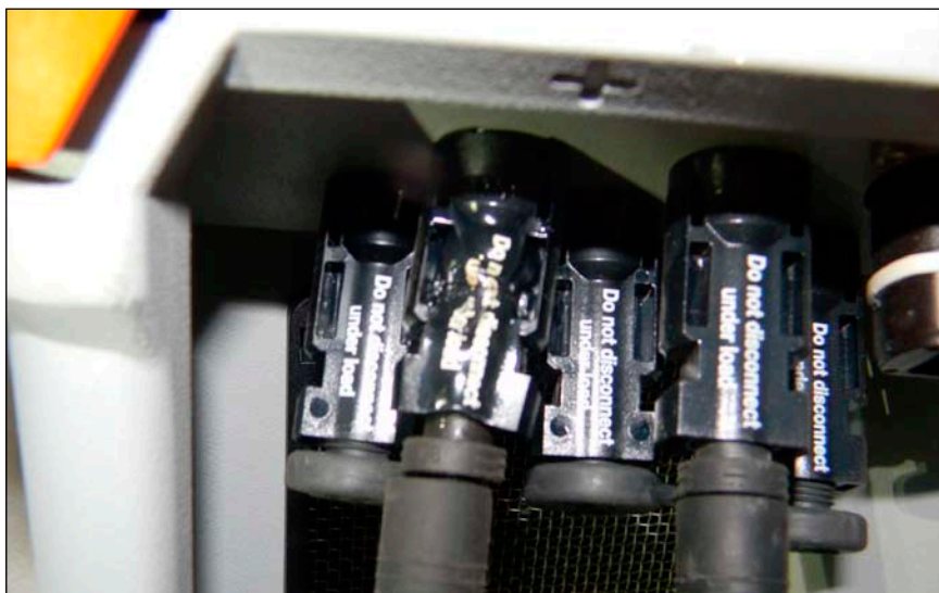
Bild 2: Mangel: Steckverbinder „steckbar“ aber nicht kompatibel: Brandschaden
