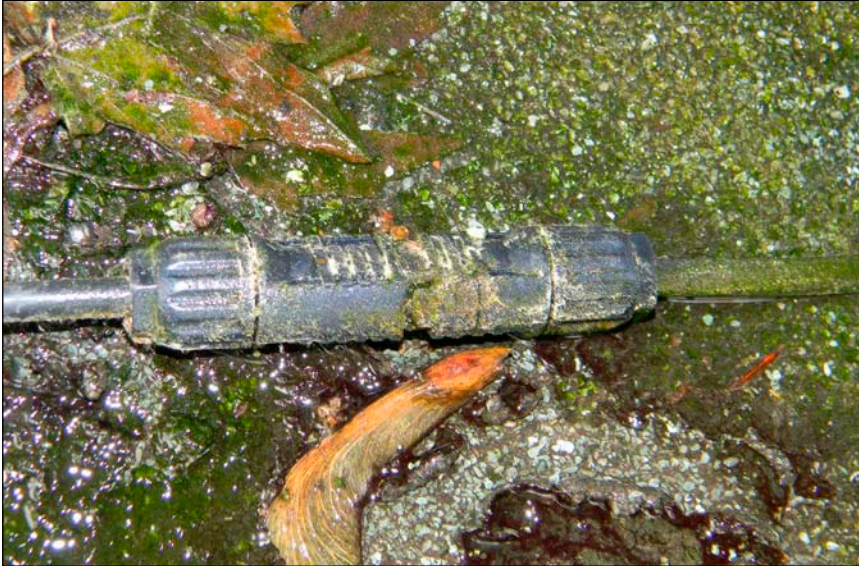
Bild 1: Mangel: Steckverbinder im Morast, Schaden vorprogrammiert
