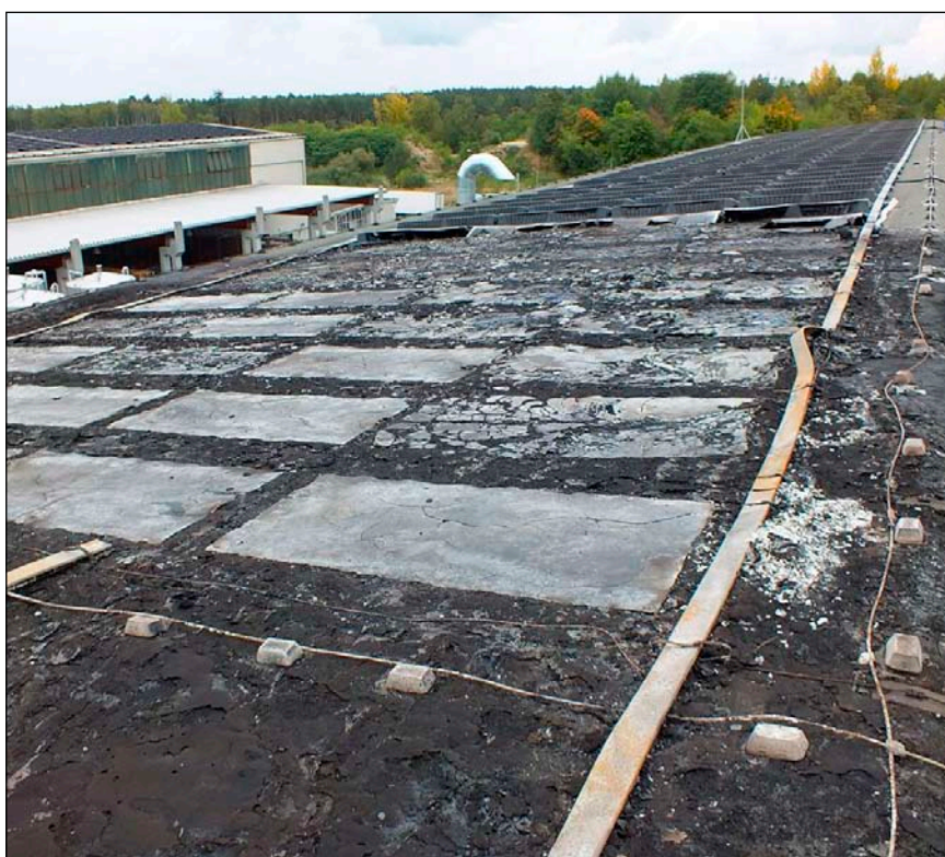
Bild 1: Brandschaden an einer aufgeständerten PV-Anlage auf einem Gewerbedach den DGS-Gutachter untersuchten
