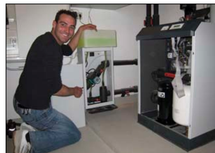
Bild 1: Da kommt Freude auf: Service bei einer Erdsonden-Wärmepumpe mit einer Jahresarbeitszahl von 4,4
