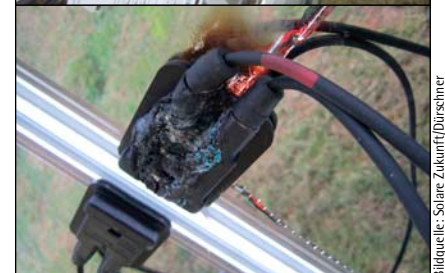
Bild 3 und 4: Moduldefekte durch Brand in der Anschlussdose
