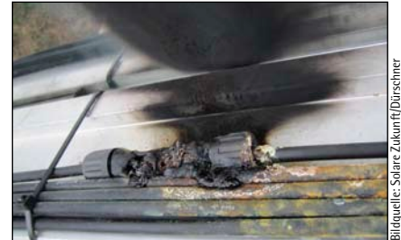
Bild 1: Brand durch mangelhaft konfektionierte Steckverbinder
